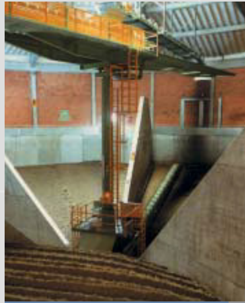
Rundsumpfanlage mit Schottwänden
